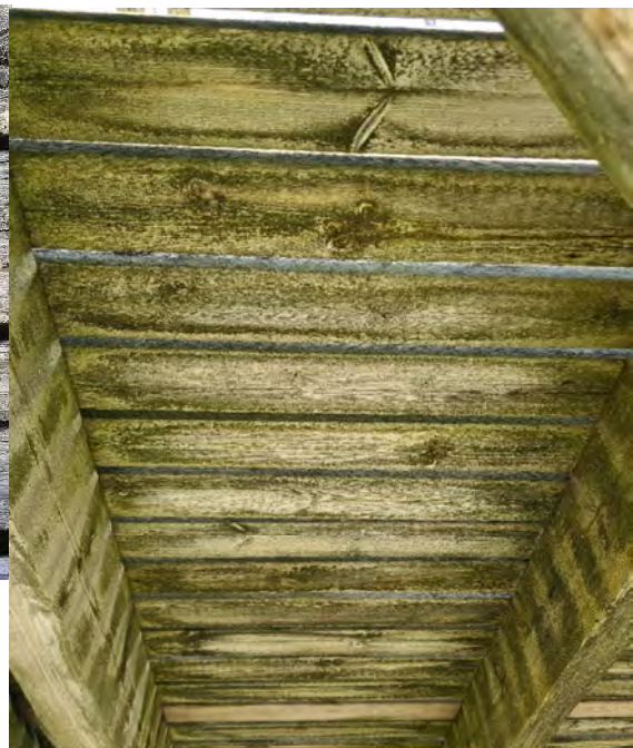
Kuva 20 Pahiten lahonnut kohta alhaalta
