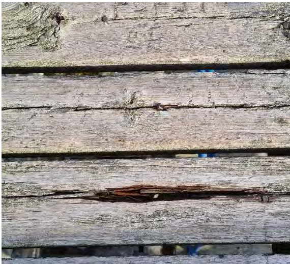
Kuva 19 Lahonnut tasolankku ylätasolla
